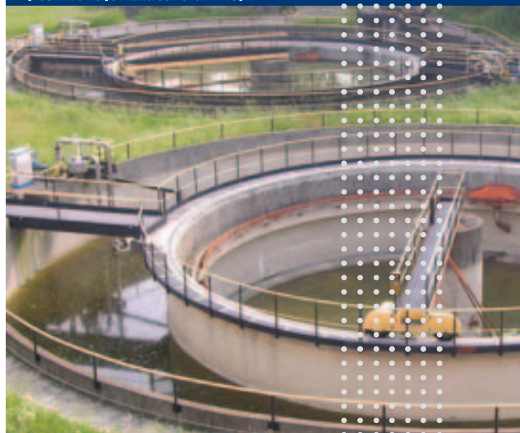
Impianto trattamento acque di Rivalta
